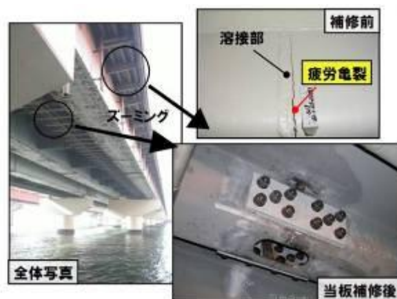
写真 1 鋼床版の疲労損傷例と当板補強
