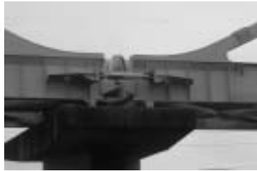
写真-3. ダンパー取付位置
