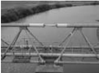
写真-2.ダンパー取付位置
