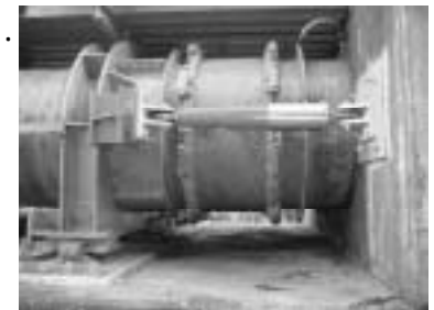
写真-4. ダンパー取付位置
