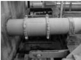
写真-1.伸縮可撓管
