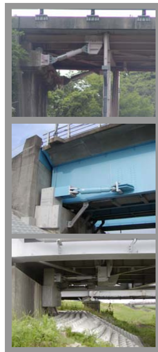
写真-1 ダンパー取付例
