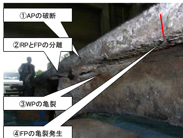
図10 伸縮装置の損傷進展過程
