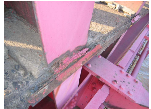
写真-4 斜材とアングルの間の隙間腐食と錆の上から塗られた塗装
