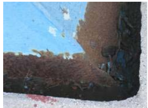
写真-1 愛岐大橋のケレン不足による8年後の腐食の状況
