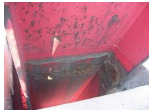
写真-2 木曾川大橋の8年前に補修・補強した部位の腐食状況
