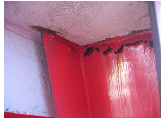
写真-3 斜材の下側のケレン不足による腐食と塗装の浮き
