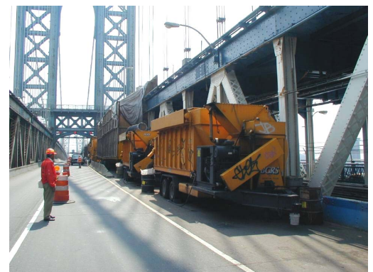
写真-5 ニューヨークの100年経過した吊橋のブラストによる塗替え塗装の例
