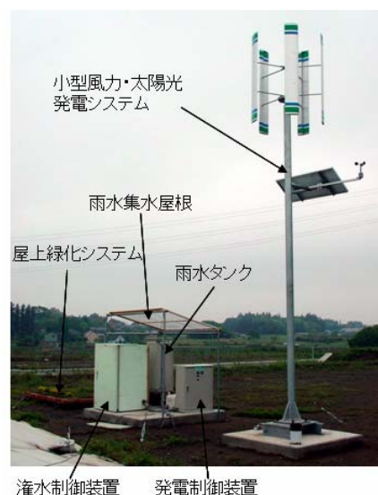
写真1 屋上緑化灌水システムの外観
