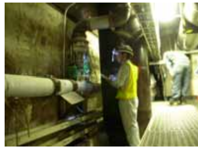
写真-2 流量計による流量点検
