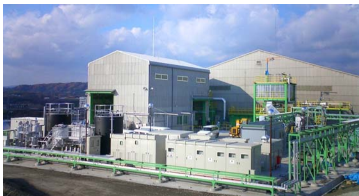
図-1 溶融分解法による無害化処理設備全景
