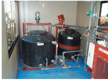
写真-2 実験装置(原水槽及び受水槽)
