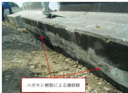
写真-1 損傷状況 (G5 桁下面)
