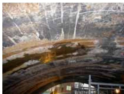
写真5 補強前状況(上床版)
