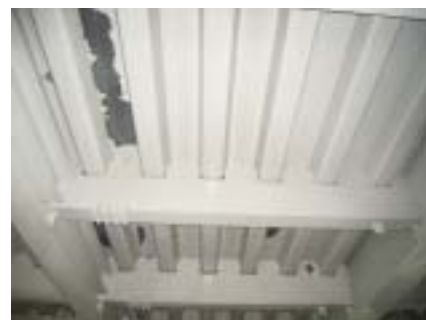
写真—1 塗膜剥離(鋼床版)
