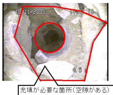
図-6 空洞状況（注入前）
