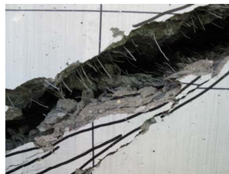
写真-3 ひび割れ部における鋼繊維の状況
