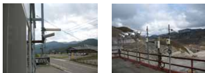
(1)試験室側アンテナ施設
