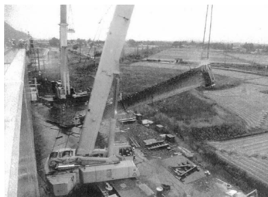
写真－1 仮設 PC 鋼棒の破断による桁の落下
