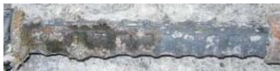
写真2 割裂後の普通鉄筋表面状況(腐食発生)
