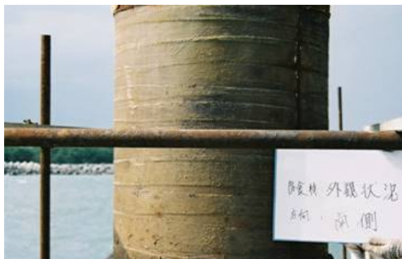
図 5 ペトロラタム系防食材の外観(暴露 19.5 年目)
