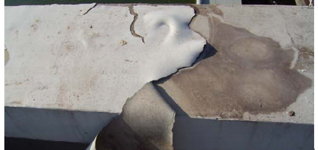
写真－3 B構造物での被覆材の剥がれ
