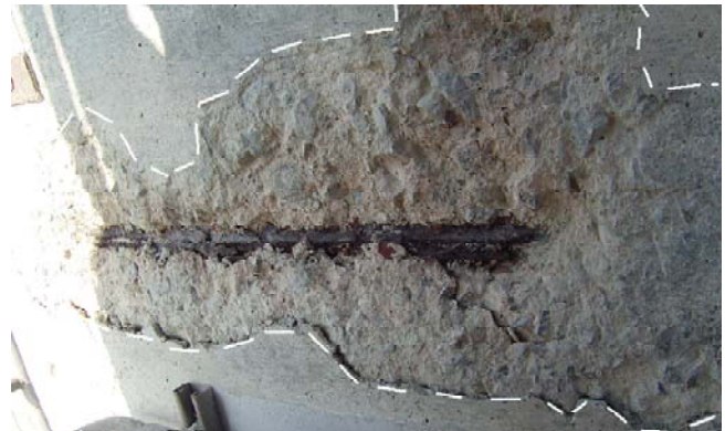
写真－4 B構造物でのコンクリートの浮き (点線が表面で確認されたひび割れ)
