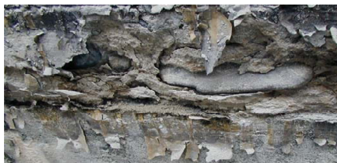
写真-1 A構造物の樹脂の剥離と劣化部の状況
