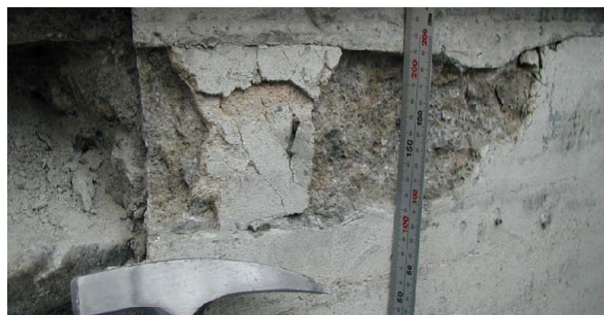
写真-2 A構造物でのコンクリートの浮き
