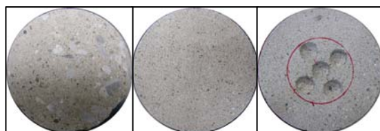
写真-2 PCM 接着面の様子
