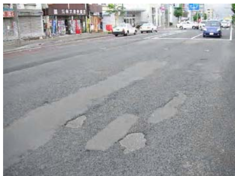
写真-1 補修対象箇所の損傷状況
