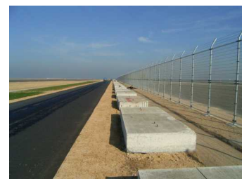
写真2 車両侵入防止ブロック
