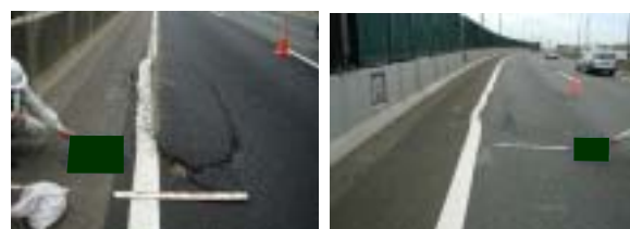
写真-1 SMA で損傷発生状況
