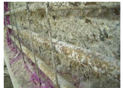
写真-2 普通丸鋼腐食状況
