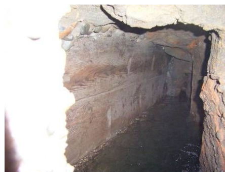
写真-2 変状詳細(SP内)
