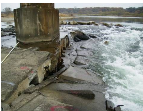
写真-1 変状状況
