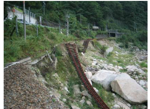
写真-1 大瀬トンネル付近被災状況
