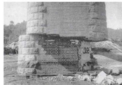
写真1 橋脚の切断・横ずれ 1)
