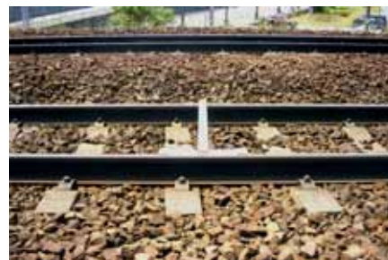
図1 まくらぎ直角狂いの発生状況
