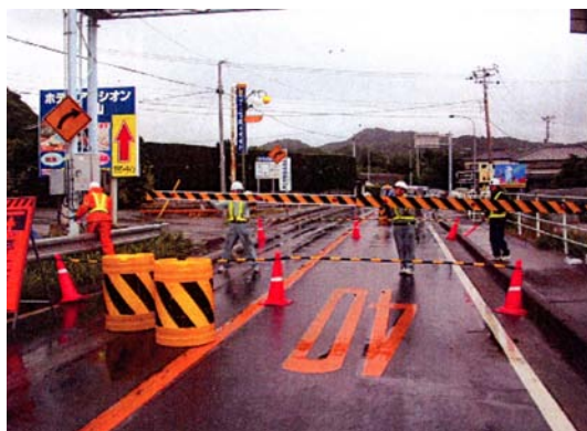
【全面通行止め規制状況】
