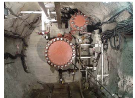
図-1 実証試験施設の貯槽前面
