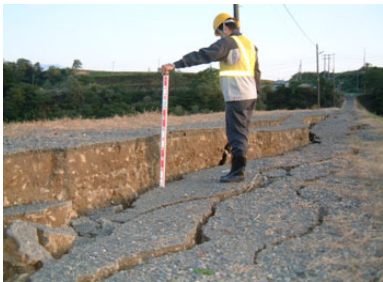
写真－1 堤体天端被災状況
