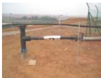
写真-5 ガス吸引井戸(No.3)
