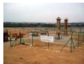
写真-4 ガス吸引施設
