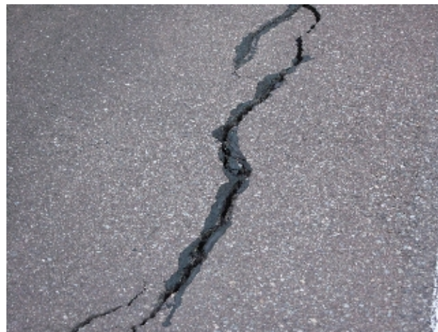
図 3 注入材を用いて補修した亀裂(2007 年能登半島地震後に撮影: 高原利幸氏)
