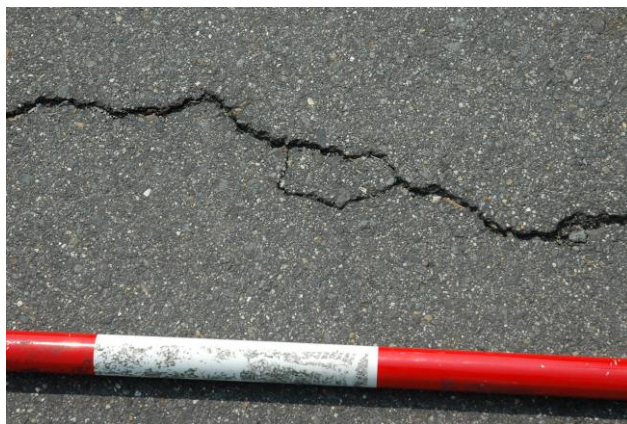
図1 アスファルト舗装に生じた亀裂
