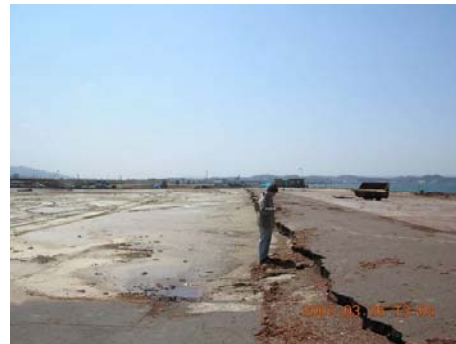
写真1 七尾市における岸壁背後地盤の被害
