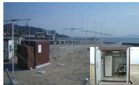
図-1 海洋短波レーダー観測施設
