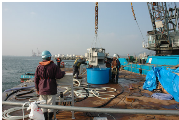
写真-3 現地運用試験 (手前が制御盤操作者)
