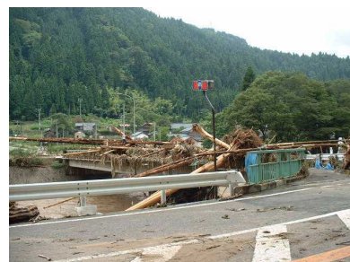
写真-1 流木の載り越し状況
