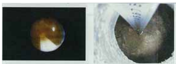
図-6 空洞状況の例
