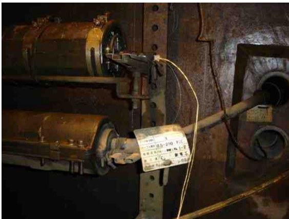
図1 MH内での光ケーブル被災状況
