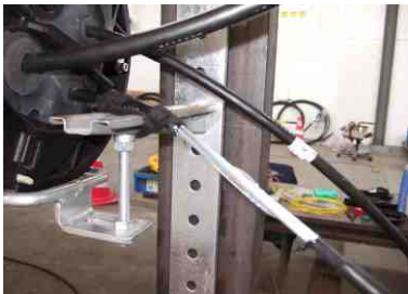
写真1 ケーブル断線状況
