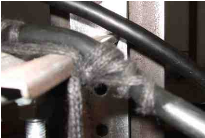
写真2 縛り紐食い込み状況
