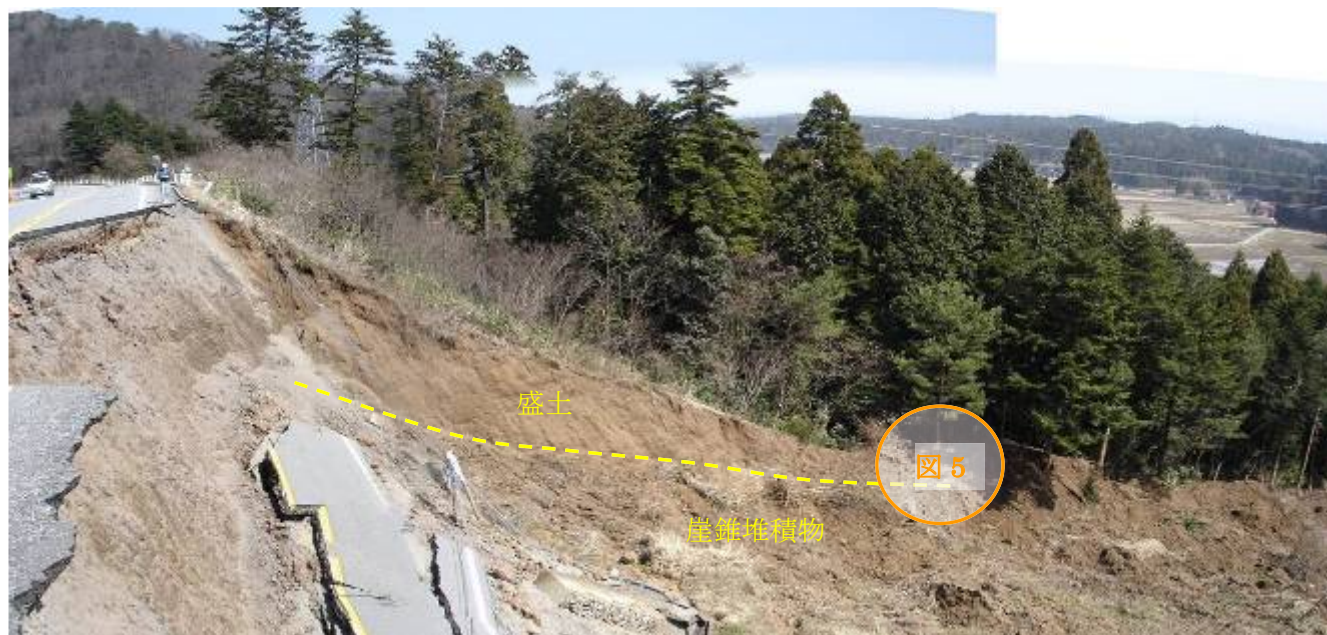
図4 崩壊断面 崩壊現場西側より撮影 (植生の違いにより、堆積物の分布が推定される)
