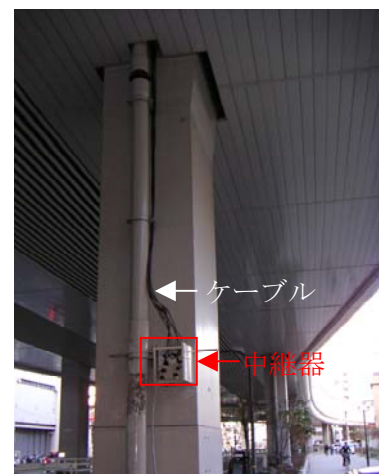
図3 中継器設置箇所
