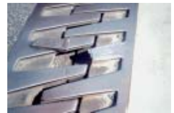
図1 フィンガーの破損事例
