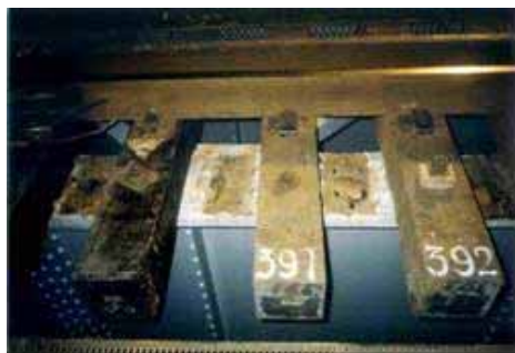
図-1 まくらぎ位置の腐食
