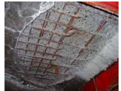
図-1 床版劣化事例
