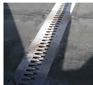
図8 P6 付近の伸縮継目の段差(図3④)
