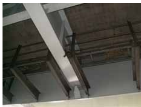
写真2 点検通路設置状況
