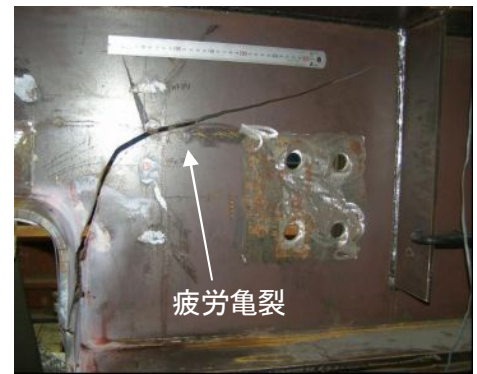
写真-2 当板補強時の疲労き裂
