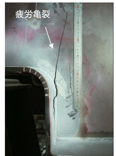
写真-1 無補強時の疲労き裂
