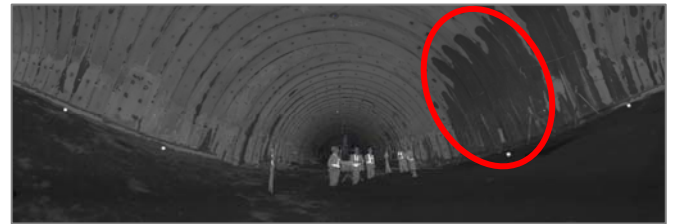
図-9 反射強度差による漏水箇所の検知
