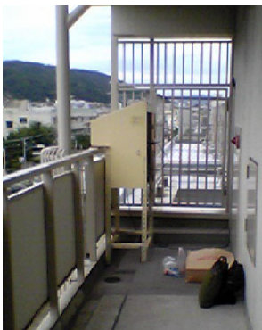
図-2 S川における機器の設置状況
