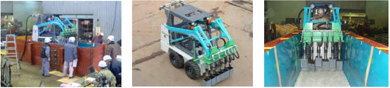
図4 試験土槽と多連装ランマによる転圧装置および転圧施工試験状況
